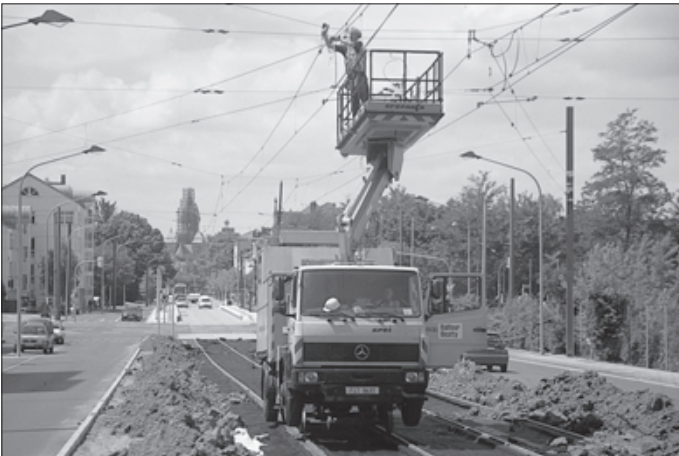
Im Juli 2004 weit fortgeschritten: der Trassenbau der Stadtbahn-Oststrecke in Heilbronn (Moltkestraße). Doch trotz einer Teileröffnung im Dezember 2004 wird der gesamte Stadtbahnast bis Öhringen noch lange Baustelle bleiben.
